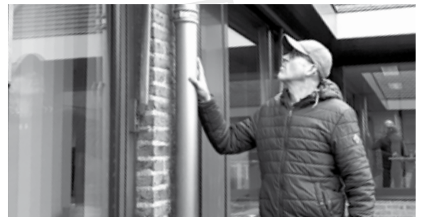
Vakspecialist Jac Broens inspecteert een afgekoppelde regenbuis van het gemeentehuis. Hij komt graag bij u langs voor een afkoppeladvies. Foto: Gemeente Nederweert.
