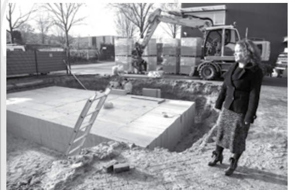
Directeur Susanne Everaerts neemt een kijkje bij de afkoppelwerkzaamheden van het bedrijf. Foto: Nederweert24
